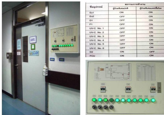
ภาพที่ 1 แสดงแผงควบคุมและคำแนะนำการเปิดระบบการทำงานห้องแยก
